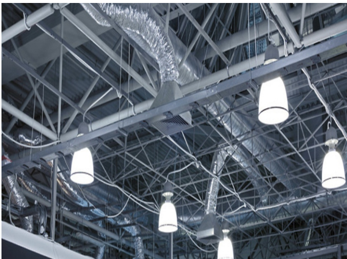
Thông gió cho nhà máy
