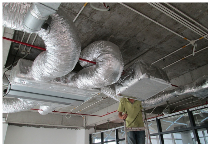
Thông gió cho nhà máy
